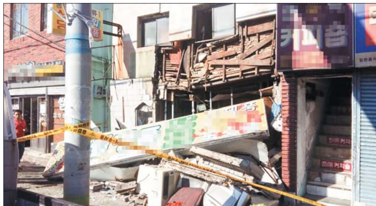
사진은 노후화와 집중호우로 건물 전면부가 무너진 남부민동 주택 모습.
