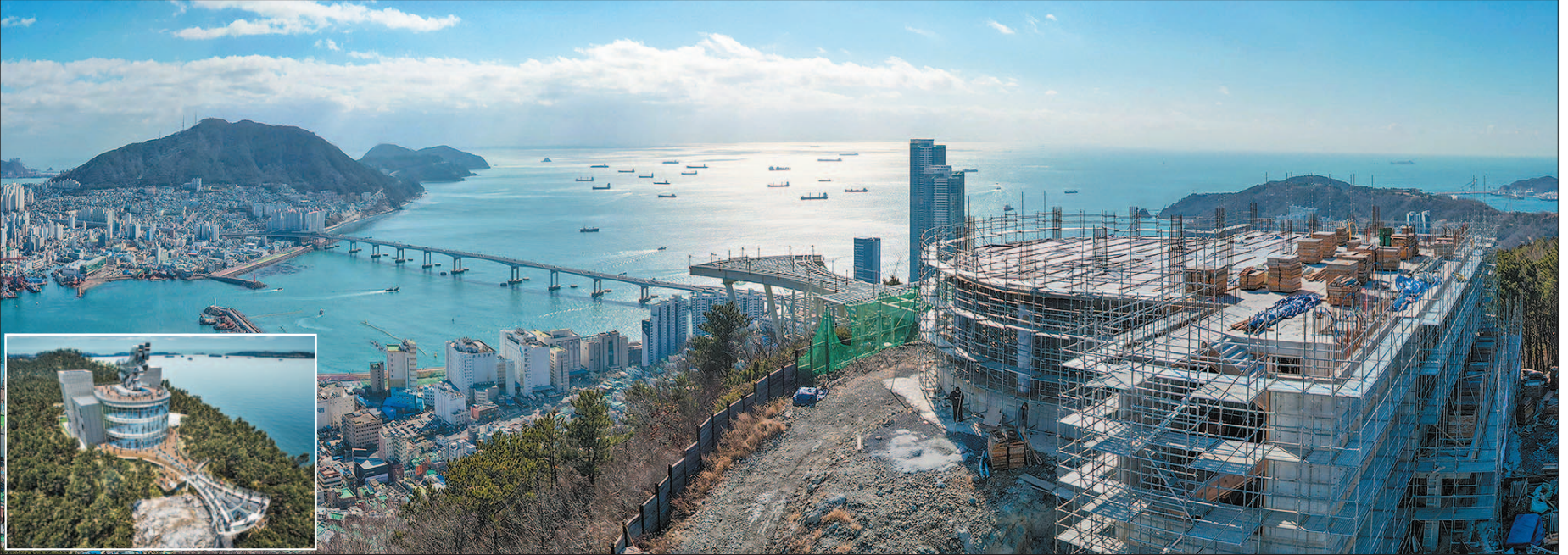
사진은 현재 3층 골조 공사가 진행 중인 천마산 복합전망대와 이곳에서 바라본 남향 등 부산 앞바다의 파노라마 풍경. 복합전망대에서 바다 쪽으로 뻗어나간 구조물이 100m 높이의 절벽 위에 설치되는 스카이워크로 하부 골조 공사가 완료된 상태다. 작은 사진은 복합전망대 조감도.
